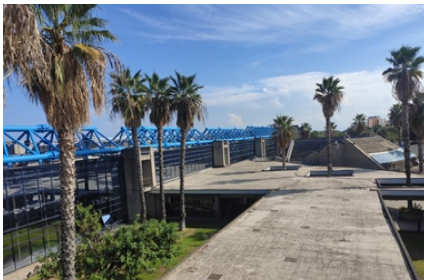
Figura 9.2 - Copertura ante operam dell'atrio del corpo B del Polo Bioscientifico, ubicato a Catania in Via S. Sofia 100 sede del Dipartimento di Agricoltura Alimentazione e Ambiente (Di3A) dell'Università di Catania.
