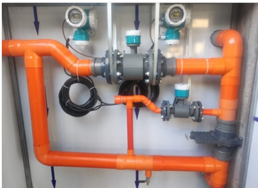
Figura 9.4 - Sistema di monitoraggio installato per ciascuna delle 3 tecnologie, oltre che il controllo, implementate per valutare l'efficacia del tetto verde in termini di ritenzione e riduzione del deflusso superficiale e delle portate.
