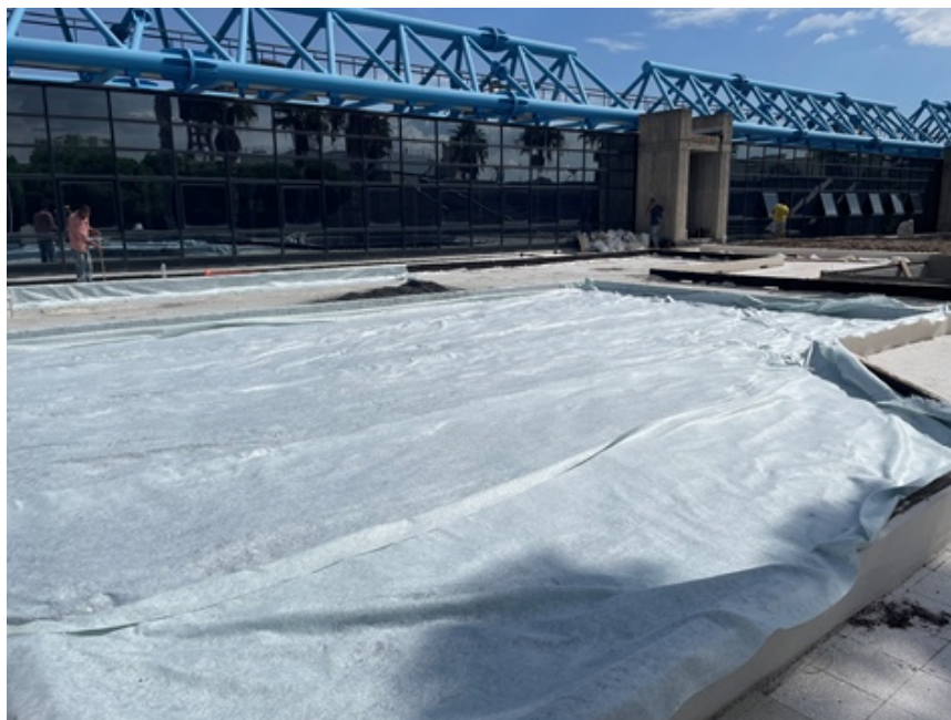
Figura 4.8 - Progetto GFLUID, Dipartimento di Agricoltura, Alimentazione e Ambiente - Catania. Posa in opera telo di separazione.
